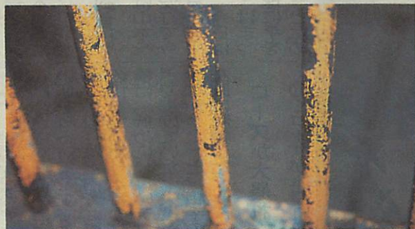
サビ止めが露出した白山公園の柵=新潟市中央区
